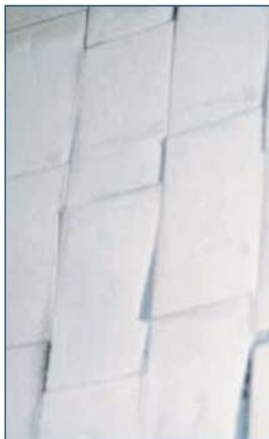
Значительная эрозия вокруг швов
