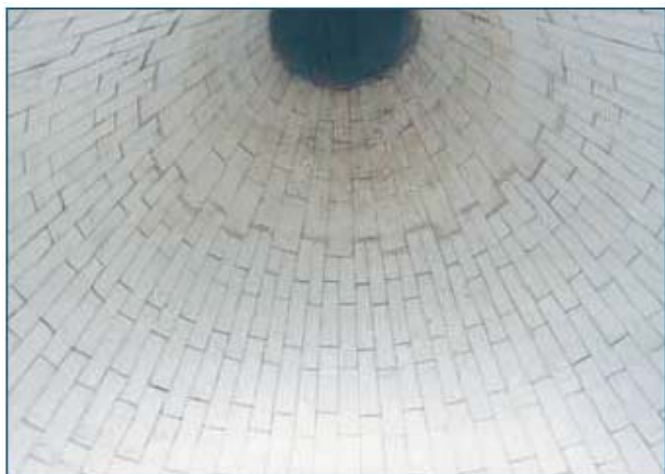
Футеровка высокотемпературного циклона отходов Мусоросжигательный завод (высокое количество коррозии) Эксплуатационный период: сталь < 1 года, керамика > 7 лет
